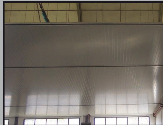
Sistema techo suspendido
